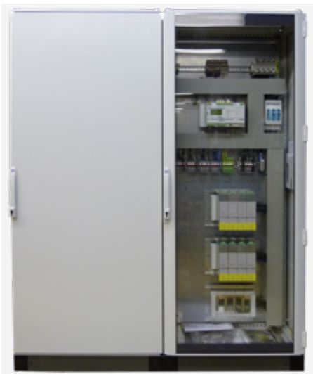
Zentralbatterieanlage mit Sicherheitsglasür.
