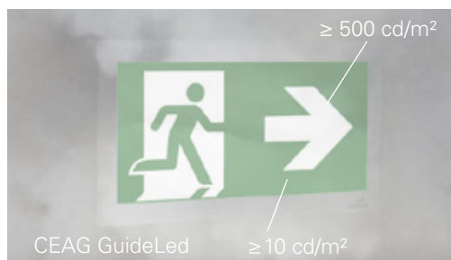
schlecht ausgeleuchtete Rettungszeichenleuchte
