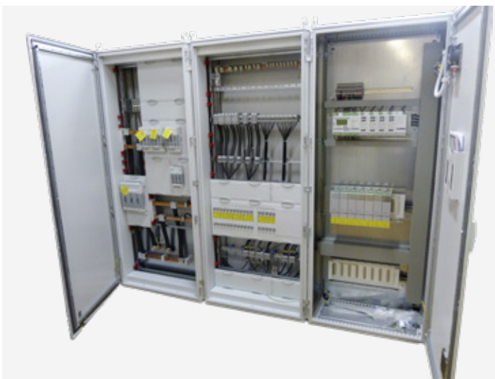
Ladeeinrichtung für Batterien bis 1000 Ah. Schranksystem mit 3 Feldern. Feld1 (links): Netz und Batterieeinspeisung Feld2 (mitte): Rangierverteiler Feld3 (rechts): Überwachung und Ladetechnik
