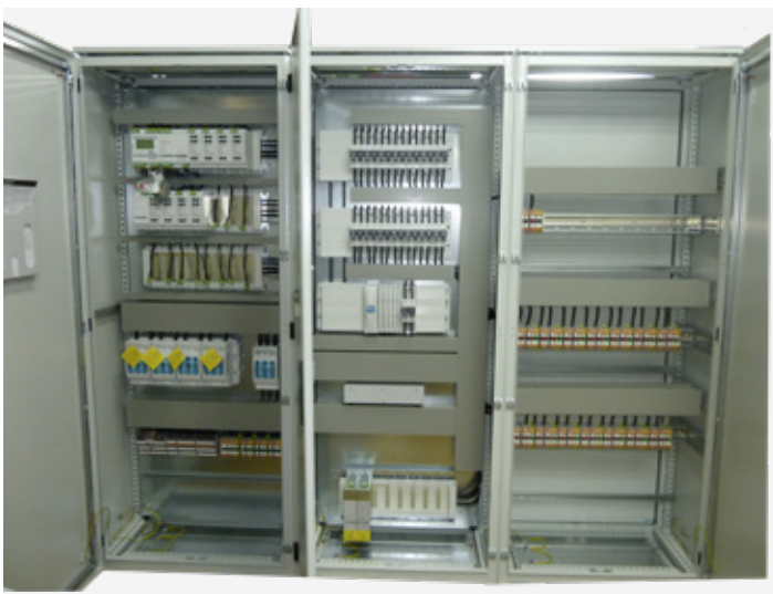
Zentralbatterieanlage mit Rangierverteiler für Unterstationen. Direkter Anschluss von 4 Batteriesätzen. Entladeströme bis 200 A. Abgänge für Unterstationen mit Lasttrennschalter. Kabelquerschnitte bis 50 mm 2 (größere auf Anfrage) Kabeleinführung von oben und unten.
